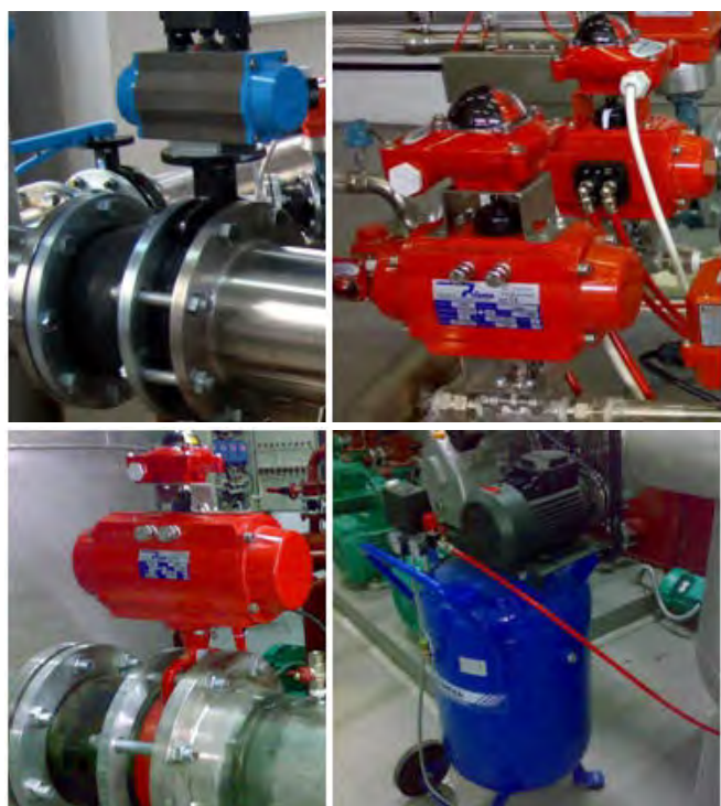
Рис. 28. Компрессоры, используемые для обеспечения питания сжатым воздухом пневмооборудования установки
